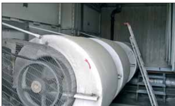
Alte Ventilatoren in einer Lüftungsanlage arbeiten unwirtschaftlich und verschwenden teuren Strom. Quelle: Sana
