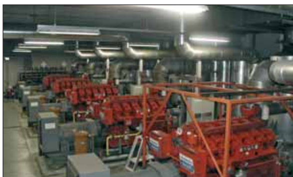
Typische Kraft-Wärme-Kopplungsanlage mit BHKW-Aggregaten
