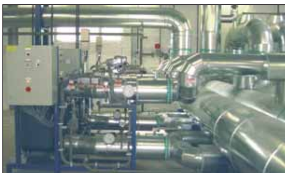
Modulare Fernwärme-Übergabestation für Heizleistungen bis 20 MW für einen Industriekunden.
