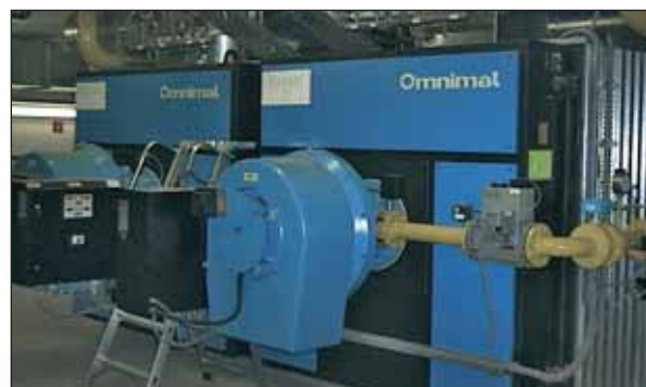
Spitzenkessel 2 x 5 MW in einer BHKW-Anlage in Berlin
